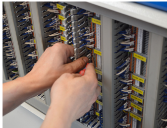
Câblage d'une armoire électrique.
